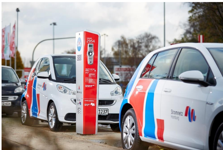
Abb. 1: AC-Normalladestation (Quelle: Stromnetz Hamburg)
